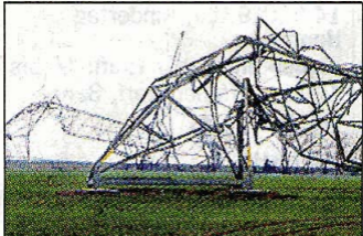
Nach dem Orkan: geknickte Strommasten
