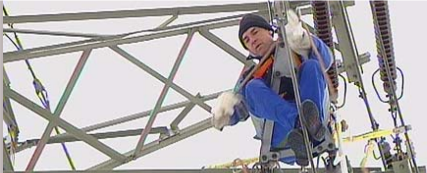
Wartung von Hochspannungsleitungen im Winter
