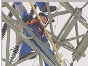
Enteisung von Hochspannungs-leitungen
