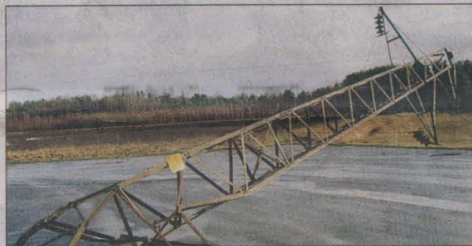
Die Spur der Zerstörung: Umgeknickter Strommast in Schweden
